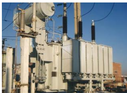
Туул дэд станц трансформатор хүчин чадлыг нэмэгдүүлэв
